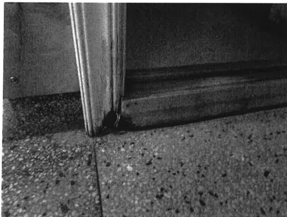
Bilde 4, fuktskade på dørkarm og listverk i dusjrom
