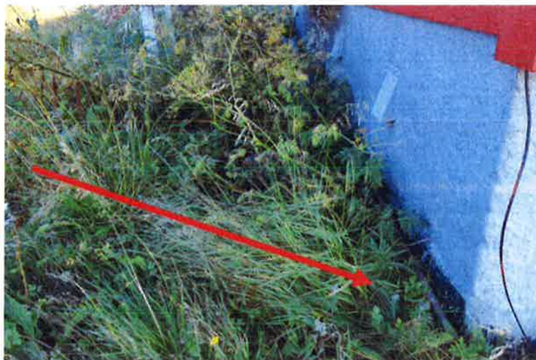
Terrenget har fall inn mot grunnmuren
