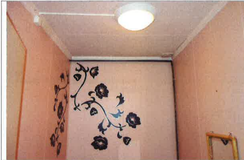
Vannrør i himling og langs vegg på WC - rom
