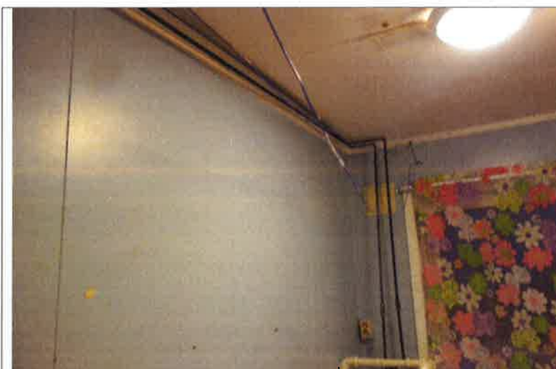
Mer av rørene i himling og ned til VV – bereder på vaskerom
