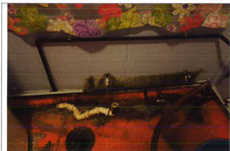
Brente rør og sviskader på vegg og gulv på vaskerom
