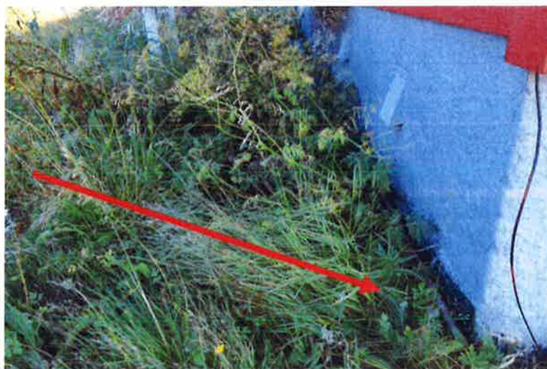
Terrenget har fall inn mot grunnmuren
