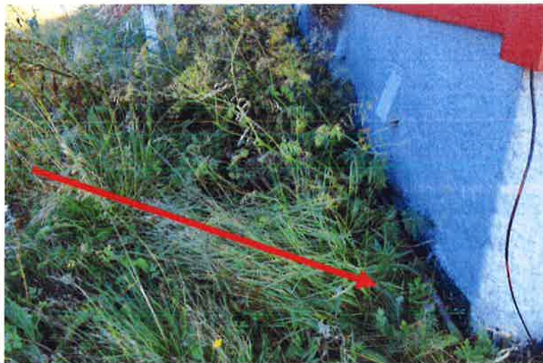
Terrenget har fall inn mot grunnmuren
