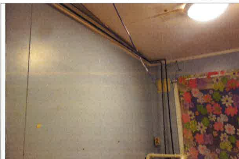
Mer av rørene i himling og ned til VV – bereder på vaskerom
