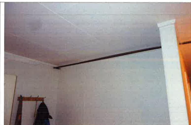
Vannrør i himling i gang
