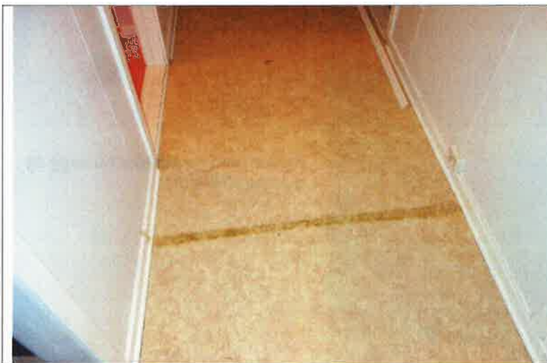
Etset stripe i gulvbelegg i gangen
