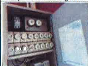
Sikrings-skap med skrusikringer
