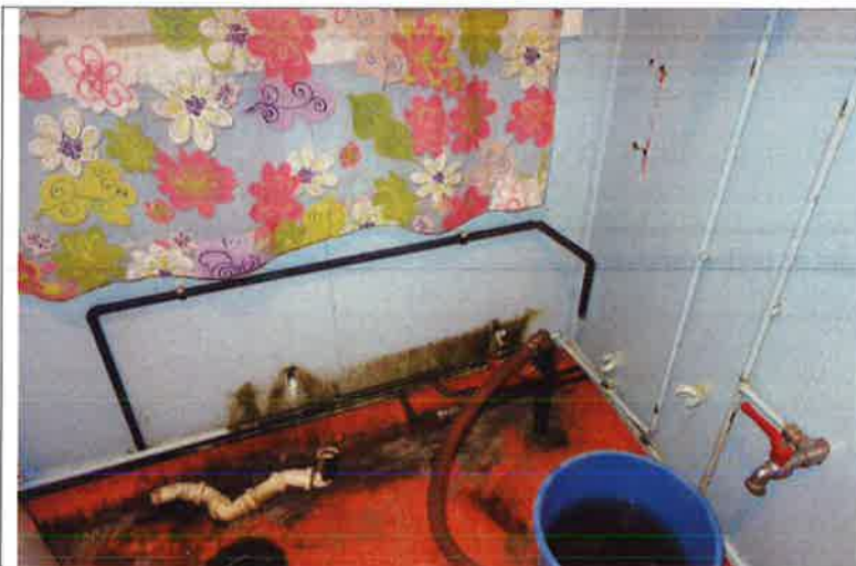
«Svidde» vannrør på vaskerommet Inntaksrør i gulv i hjørnet
